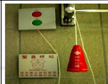
廁所多處緊急呼叫鈴
